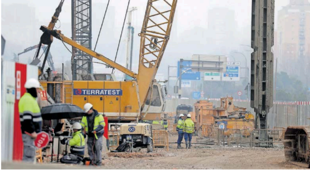
Un grupo de trabajadores en una obra en Madrid, el 12 de enero. JAIME VILLANUEVA
