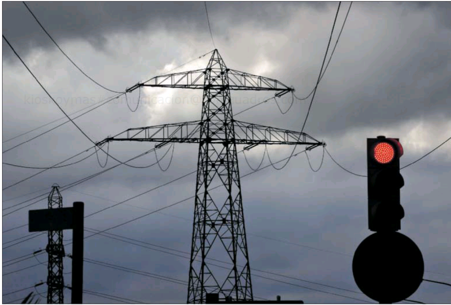
Una torre de alta tensión eléctrica en una línea de transmisión a su paso por Terrassa (Barcelona). / CRISTÓBAL CASTRO
